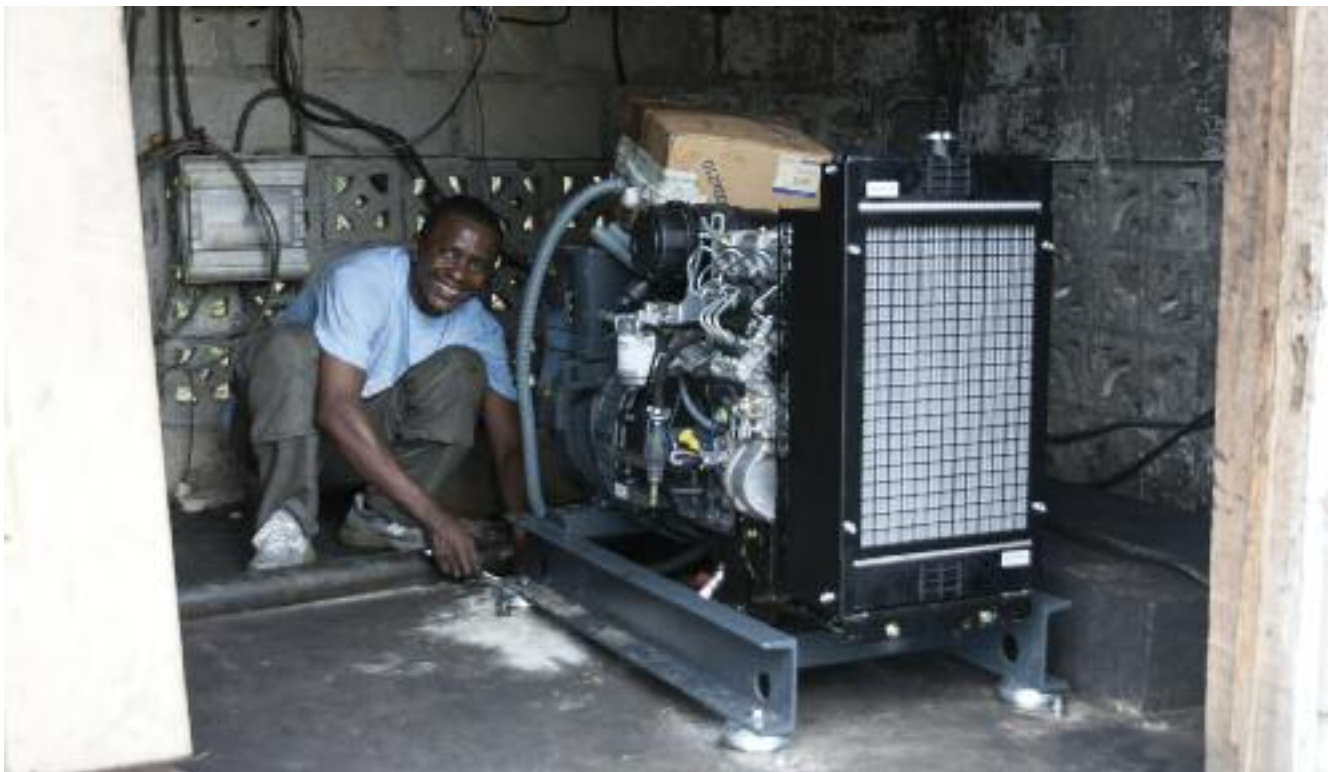
De generator staat vast op zijn plaats.
