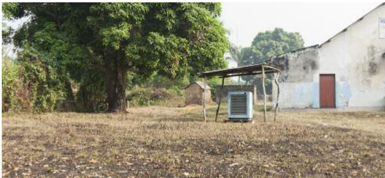
De generator, onbeschermd en defect.
